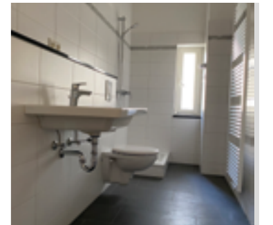
Fachleute haben das Badezimmer neu gefliest und mit moderner Sanitärkeramik ausgestattet sowie die Elektrik erneuert.
